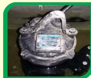
EFFLUENT PUMP & JET AERATOR
