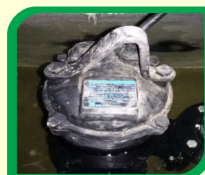
EFFLUENT PUMP & JET AERATOR
